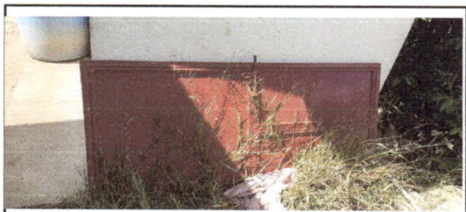
Foto 5: sujecion y mantenimiento puerta de sanitario.
